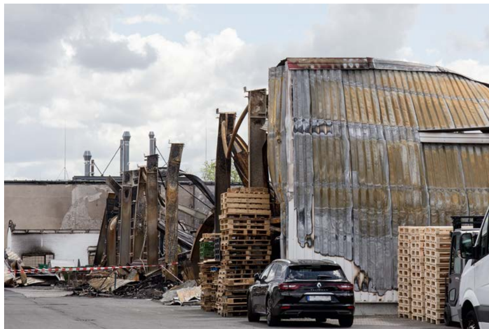
Brandschaden Reste einer Lagerhalle in der Flohrstraße
